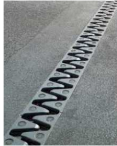
FIGURE 1.2: Exemple de joint de dilatation -appelée joint de chaussée - avant le tablier d'un pont.
