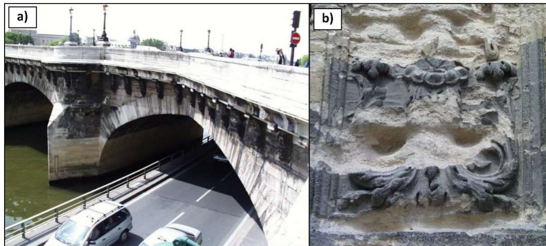
Figure 4 : illustration des effets de la pollution sur le bâti à Paris : a) présence de croûtes noires sur le Pont Neuf b) détachement spontané de croûtes noires sur une pierre poreuse (sculpture de l'église St-Eustache)
