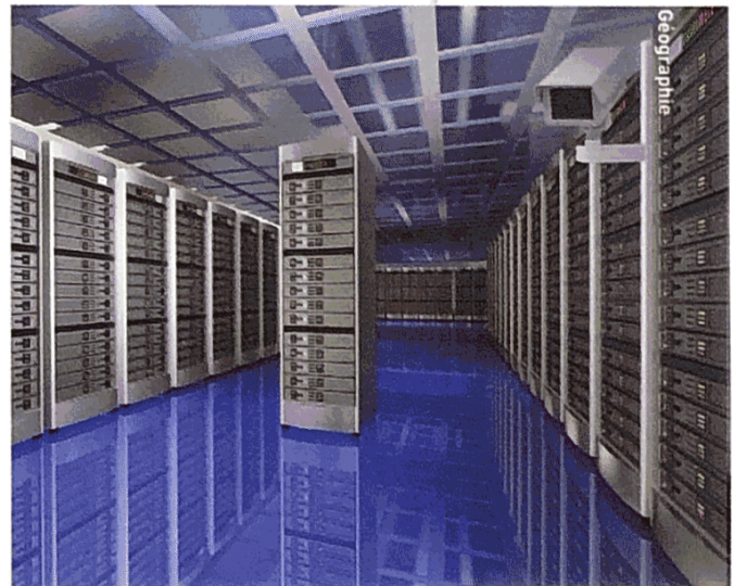
Les serveurs des centres de données (Data Center)
